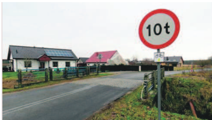
► Przez niewielki most w Sławoszewie mają przejeżdżać znacznie cięższe pojazdy niż nośność konstrukcji. Mieszkańcy obawiają się, że może dojść do uszkodzenia mostu
