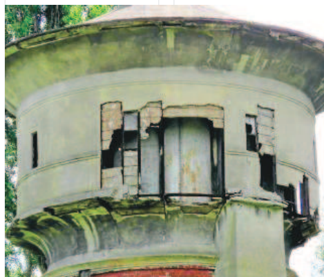
Dopiero z bliska widać, że wieża wymaga remontu
